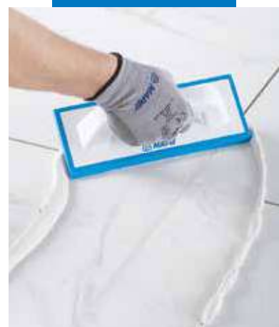
Könnyen felhordható epoxi fugázó
